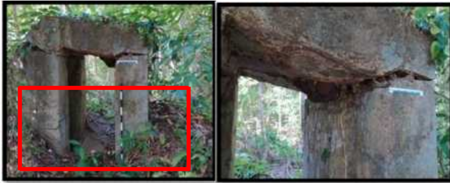
Gambar 5. Contoh kerusakan yang perluditambahkan sloof (Sumber: Dok. Andi Hardianti, 2020)
