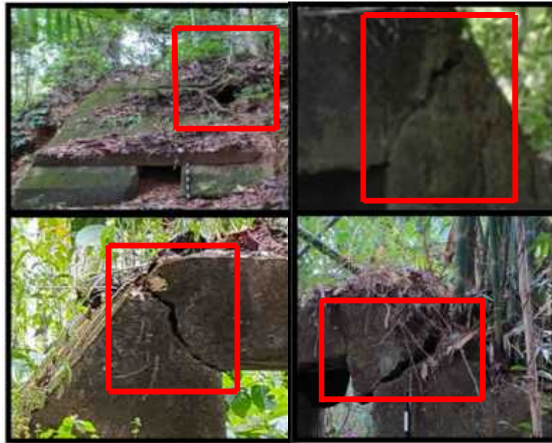
Gambar 3. Bentuk Kerusakan Retakan Tekan (Sumber: Dok. Andi Hardianti, 2020)
