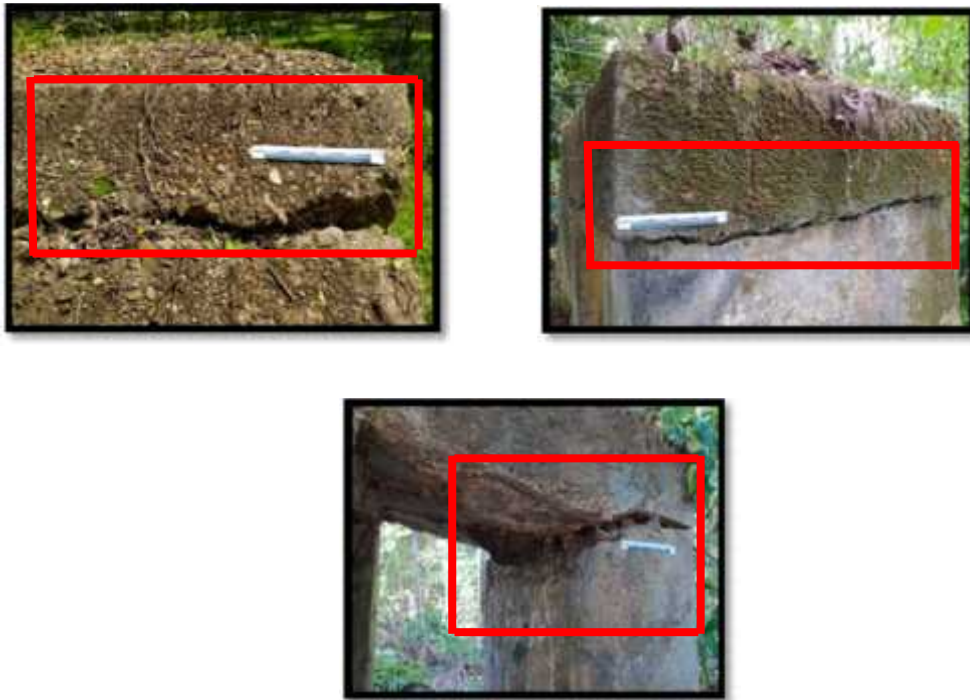
Gambar 2. Bentuk Kerusakan Retakan Tarik (Sumber: Dok. Andi Hardianti, 2020)
